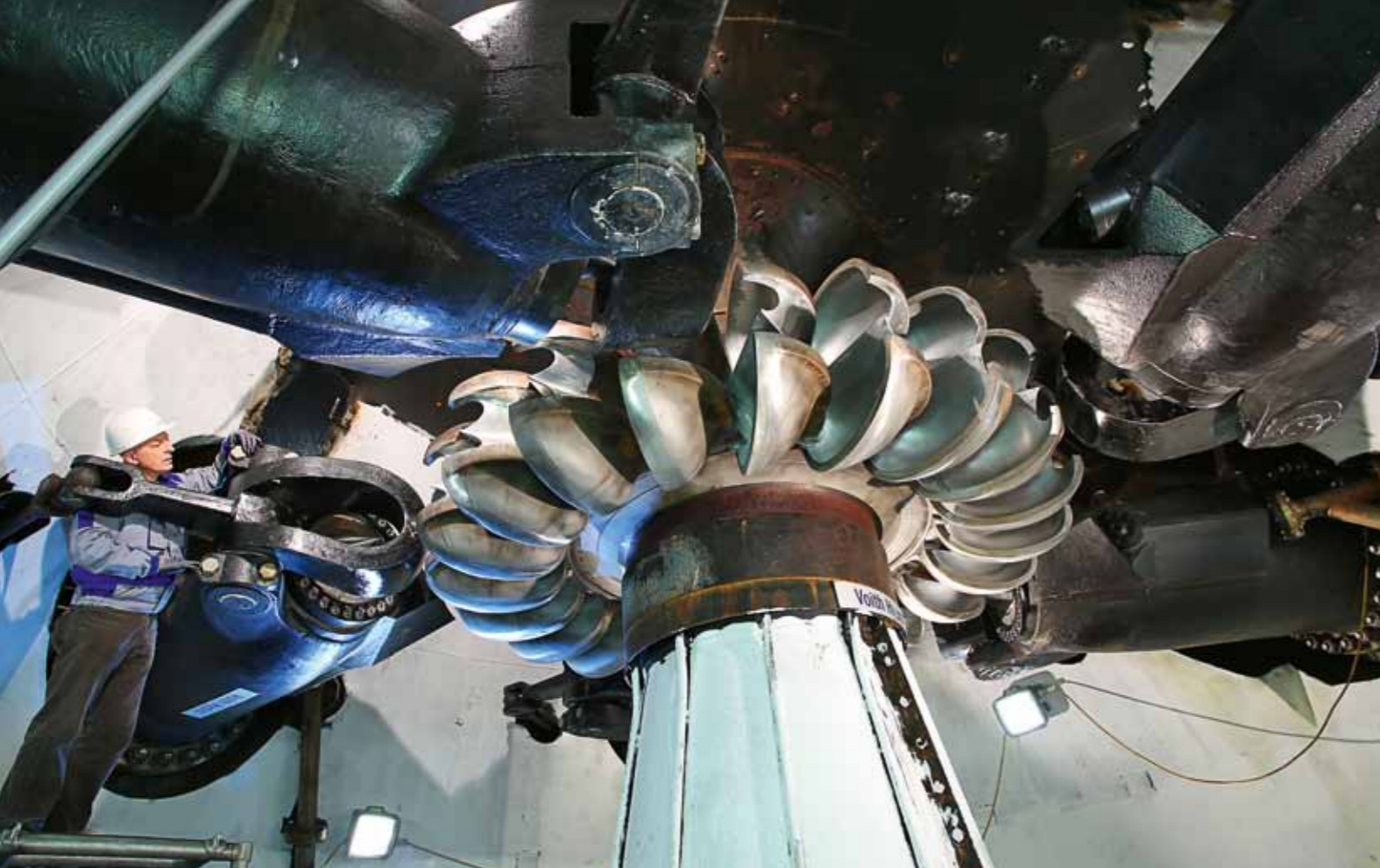
Pelton-Laufrad mit spezieller Tosi-Düse, nach der Revision vollständig montiert und bereit für Inbetriebnahme.
